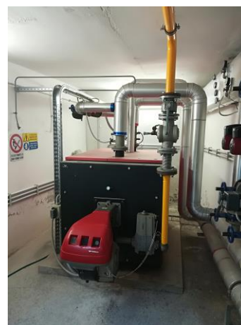
Figura 8.9 - Particolare del generatore di calore attuale
