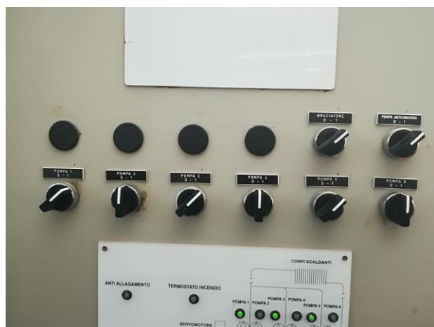
Figura 4.4 - Particolare del pannello di controllo di dell’impianto termico
