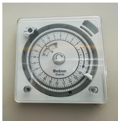
Figura 4.5 – Orologio generale a servizio dell’impianto termico
