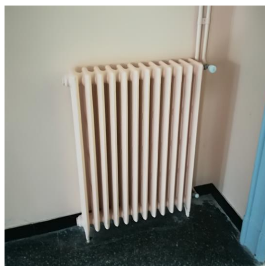
Figura 4.3 - Particolare dei radiatori installati sulle pareti esterne degli ambienti
